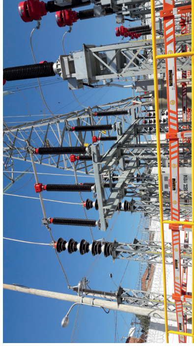
Figura 2. Subestação Poções II – Município de Poções – Bahia Fonte: Eletropaulo.
