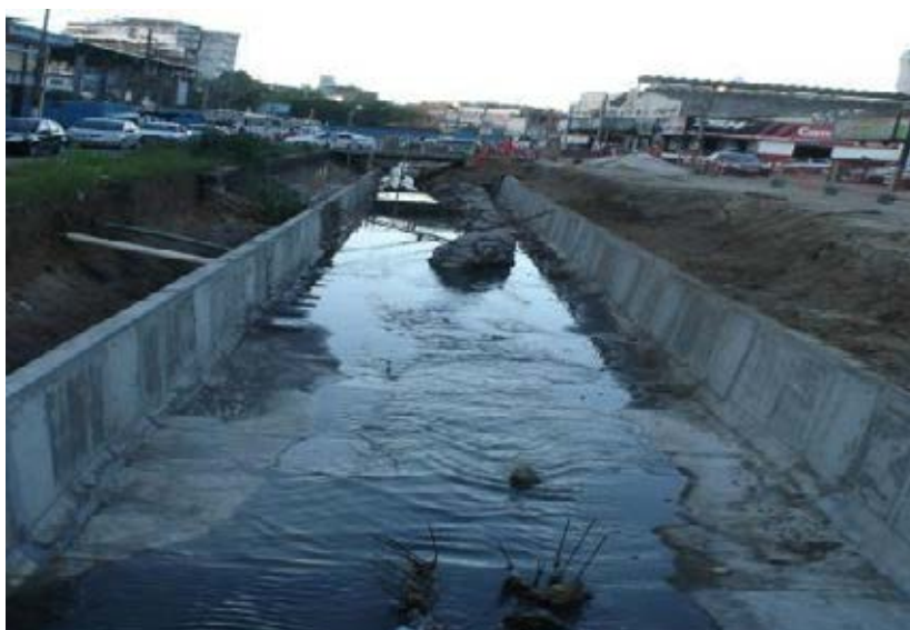
Figura 4 – Esgoto a céu aberto em Itabuna – BA
