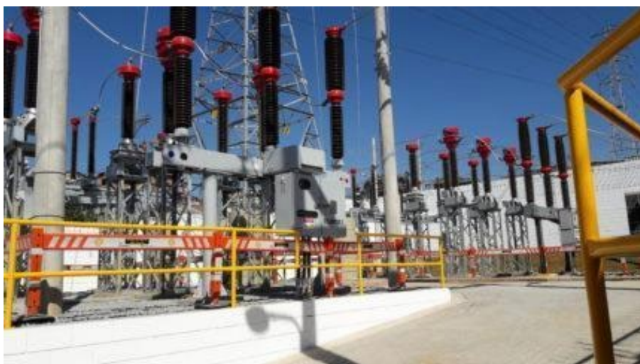
Figura 3 – Subestação Poções II – Município de Poções - Bahia
